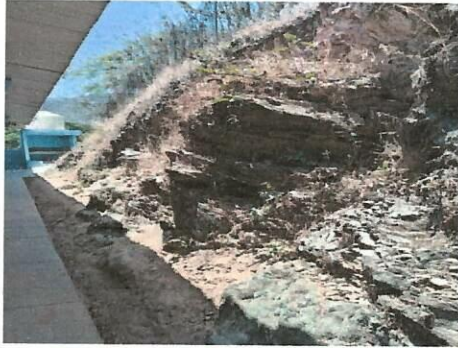
Foto 1: se realiza reparacion de muro de contencion con refuerzos, debido a que no esta en buenas condiciones, ocasionando peligro para los alumnos
